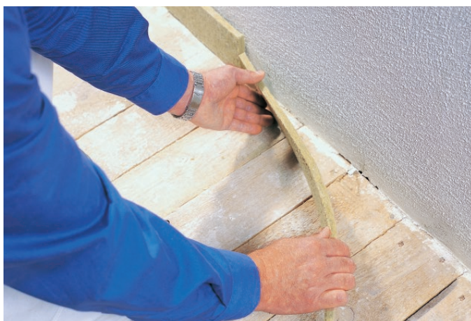
Grafika 23: Układanie brzegowej taśmy przyściennej z wełny mineralnej Knauf, jeżeli istnieją wymogi dotyczące ochrony przeciwpożarowej
