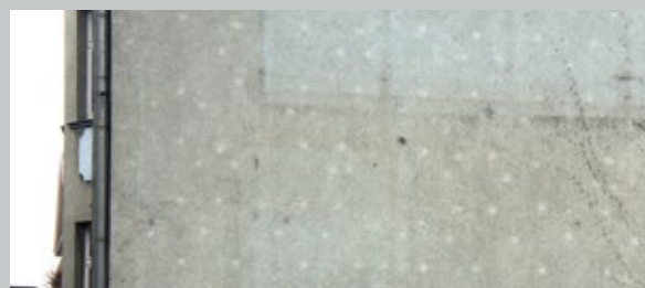
Dübelabzeichnungen am WDVS zeigen besonders die Verschmutzung sowie den Algen- und Pilzbewuchs auf.
