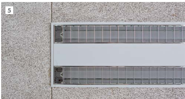
5 Fertig eingebaute Rasterleuchte. Plattenfuge wird durch den Blendrahmen abgedeckt.
