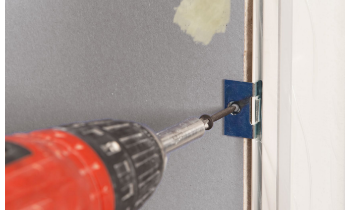
Bild 14: Festschrauben des Monoblockglaselements
