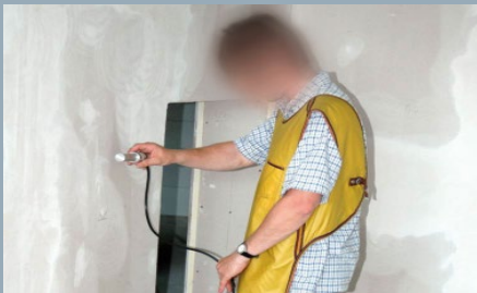
Abnahme der Funktionstüchtigkeit vorgeschrieben
