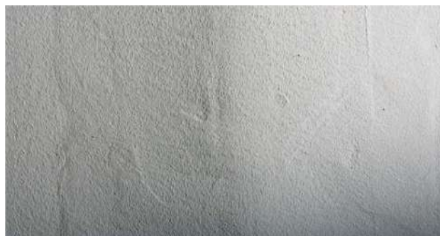
Joint enduit en relief sous une forte lumière rasante
