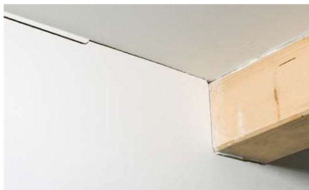
Fissure discontinue en raison de l'absence de séparation des éléments de construction.
