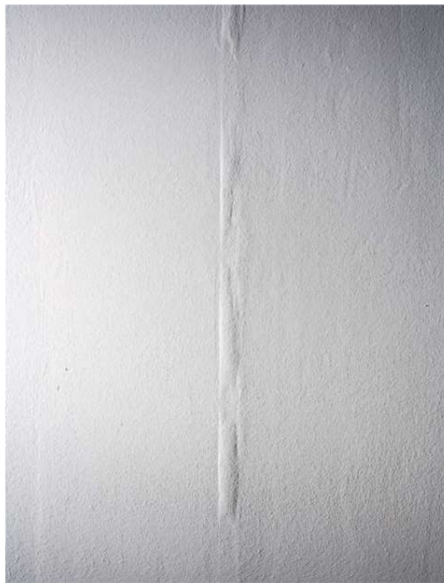
Décollement d'un seul côté et décollement partiel de la bande couvre-joint après peinture
