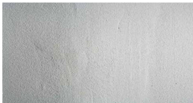
Joint enduit en relief sous une faible lumière rasante
