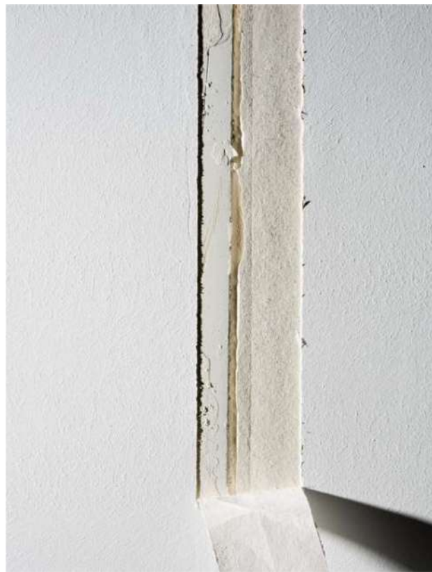
Cause : trop peu d'enduit sous la bande couvre-joint du côté SK (partie gauche du joint)
