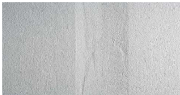
Joint enduit en creux sous une forte lumière rasante
