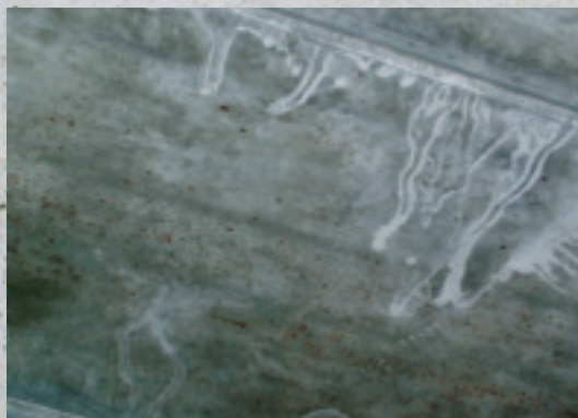
Kalkafzettingen of cementsluier op beton.
