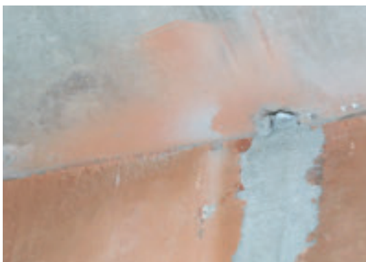
Stof op het oppervlak van beton.
