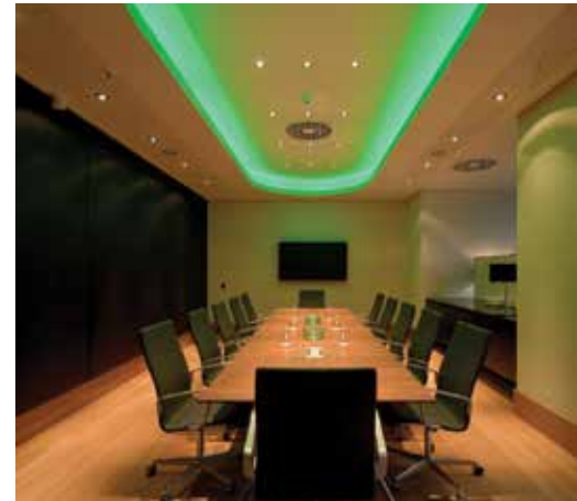
Η εγκατάσταση του φωτισμού LED γίνεται σε εσοχές σχήματος U στην οροφή π.χ. σε αίθουσες συνεδριάσεων
